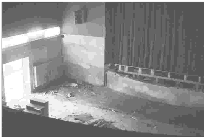
1998-lipiec kino zniszczone przez powódź
